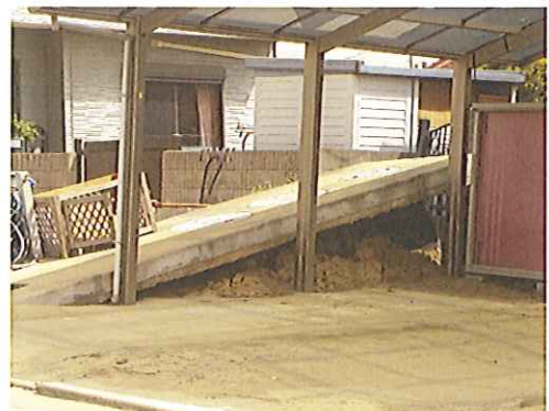
写真)液状化による隆起。もともとは平な道だった。
